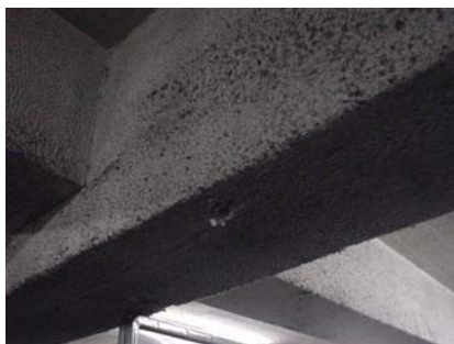
アスベスト吹付け状況 (梁、天井表面にアスベストが吹付けられています。)
