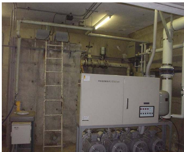
水再利用設備（中水設備）
